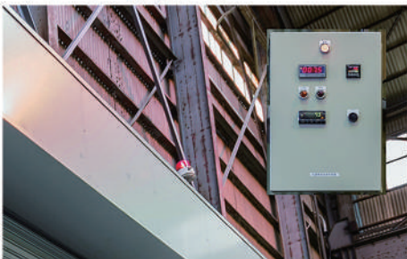
結露警報監視盤による管理システム
